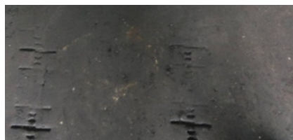
除雪機による凹み ※自転車のスタンドでも このように凹みます。
