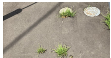
スギナによる突き抜け
